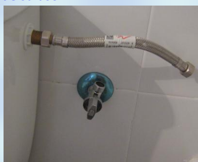
Figura 1: Toma de la Cisterna
